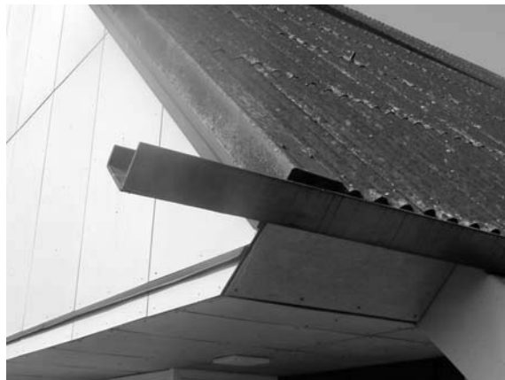
Lastre ondulate in fibrocemento amiantoso, foto: IST
