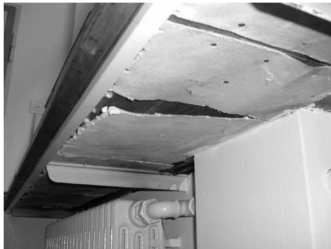
Cartone d'amianto accessibile sotto le finestre, foto: Laboratorio cantonale di Basilea-Città
