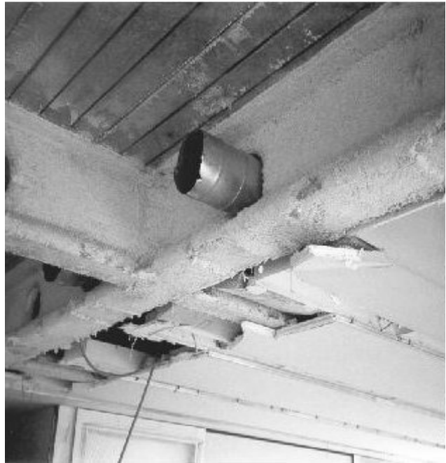
Floccato d'amianto in una struttura portante in metallo, foto: IST
