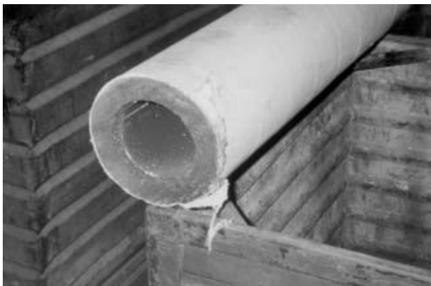
Isolazione di tubazioni contenente amianto, foto: IST
