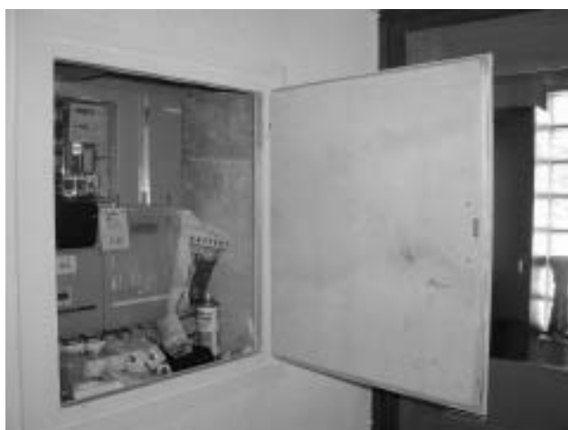
Scatola dei fusibili con lastra antincendio all'amianto sulla porta interna, foto: IST
