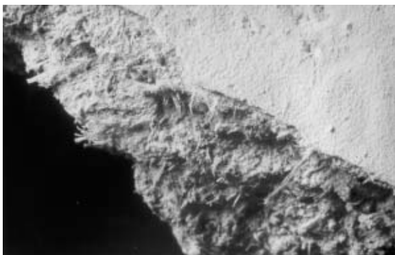
Lastra spezzata in fibrocemento con amianto, con ciuffi di fibre d'amianto visibili, foto: SA
