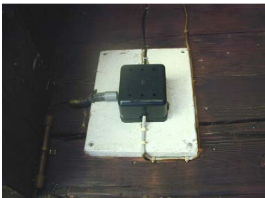
Carton d'amiante derrière un boîtier téléphonique
