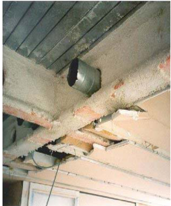
Amiante floqué sur structure métallique
