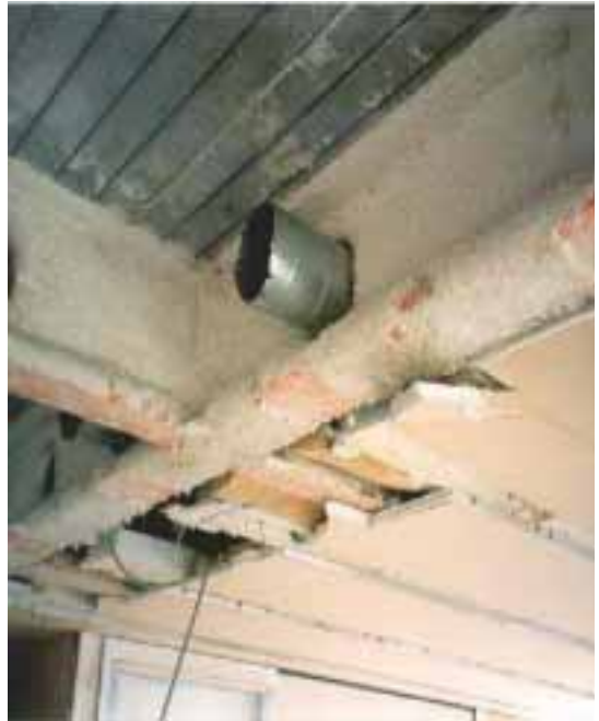
Amiante floqué sur structure métallique
